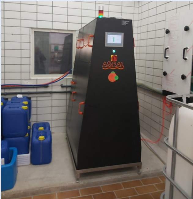
Bild 2: Technische Anlage zur Erzeugung von Chlordioxid während der Pilotversuche
